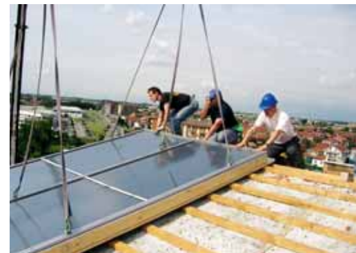
Impianto solare termico di grandi dimensioni su un condominio
